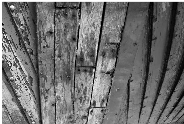
Рис. 2. Химическое разрушение древесины
