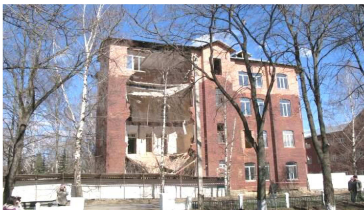
Рис. 1. Обрушение фасада учебного корпуса одного из вузов Вологды, вызванное морозным пучением грунтов в процессе капитального ремонта
