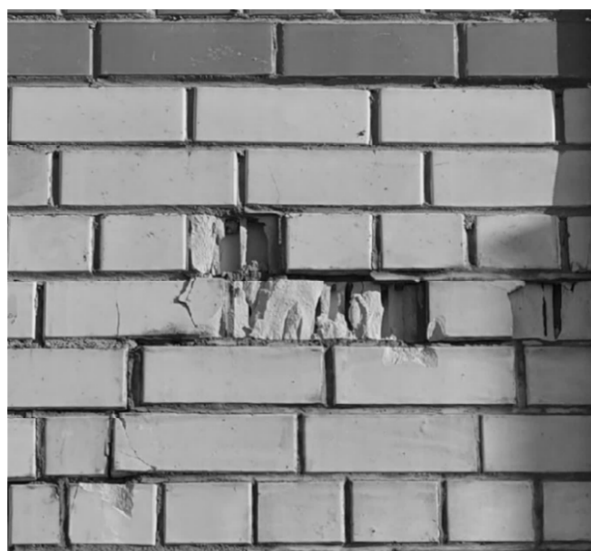
Рис. 2. Разрушение облицовочного слоя из лицевого пустотелого керамического кирпича в 10-этажном жилом доме (Вологда, ул. Старое шоссе)
