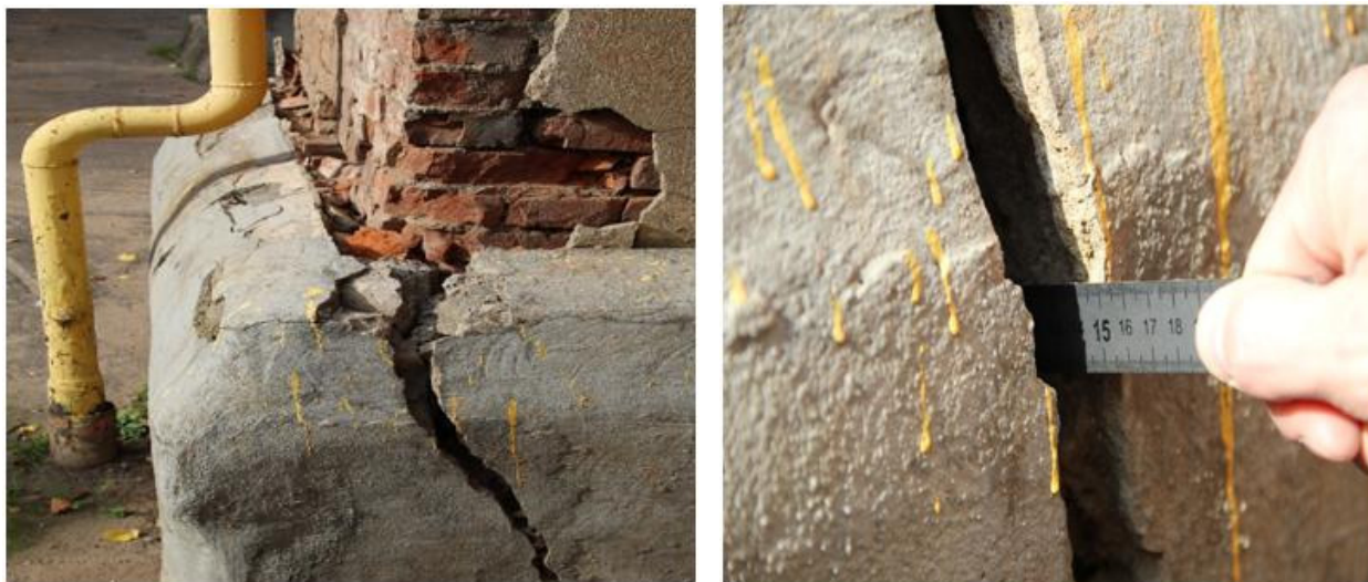
Рис. 7. Трещины в цоколе
